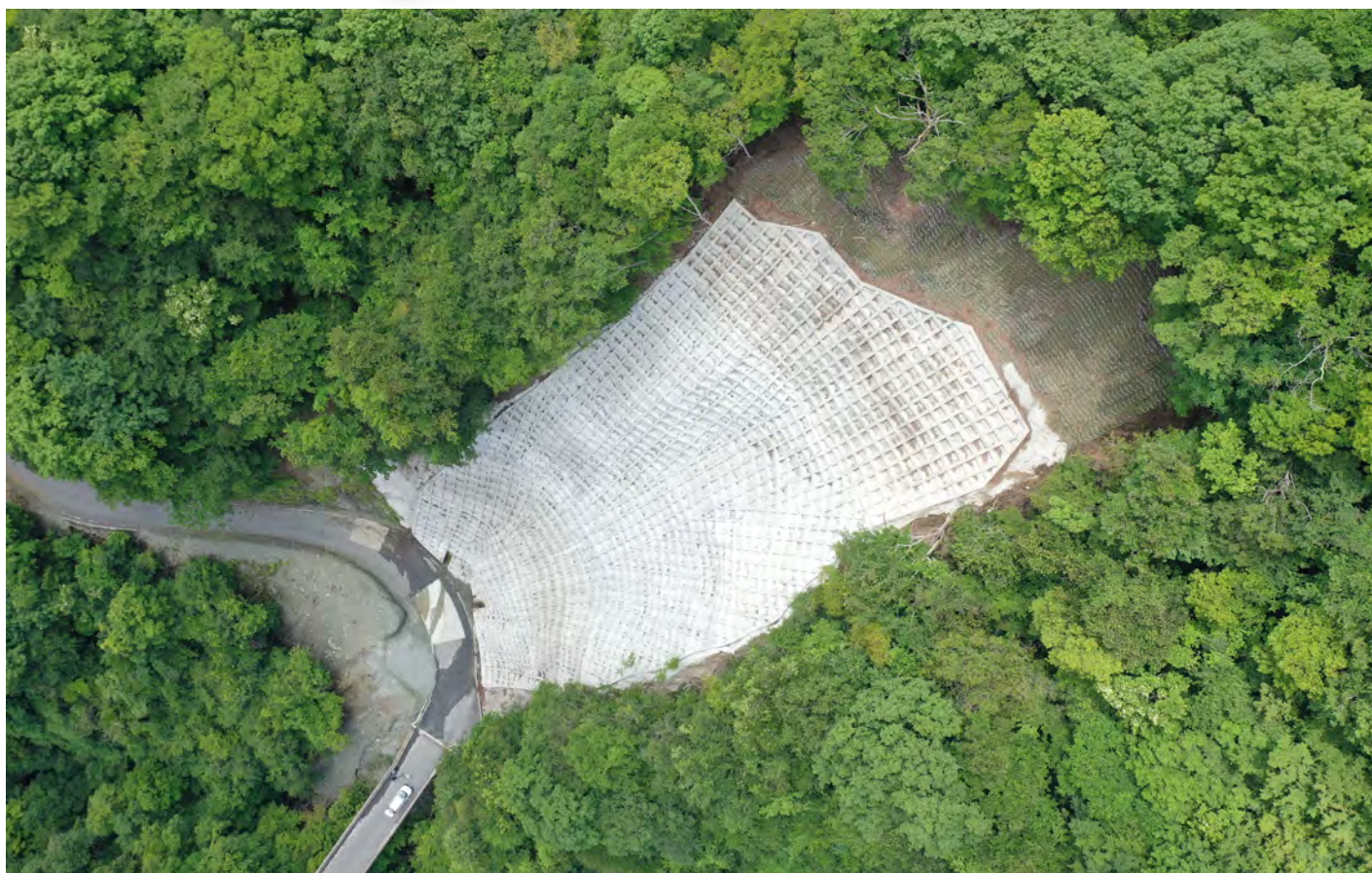
林道と治山の事業連携によるみどりの復旧（足柄上郡山北町皆瀬川 伽藍沢）
